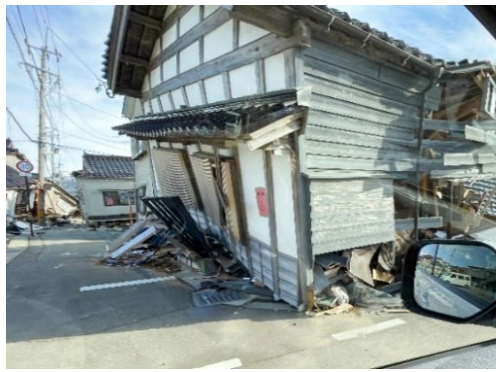
輪島市内の建物被害の様子
